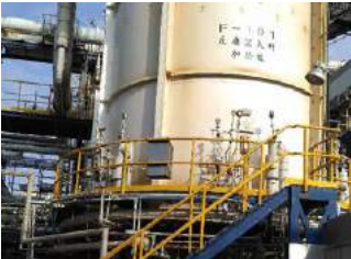
鍋爐設備節能
